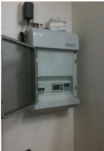
Стандартна cabina в техническо помещение
